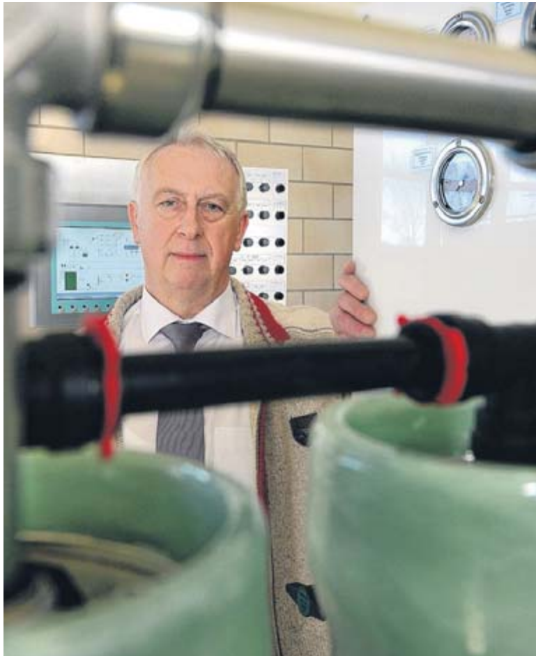
Dieter Hartmann an einer Wasseraufbereitungsanlage, die aus Trinkwasser hochreines Wasser macht.
